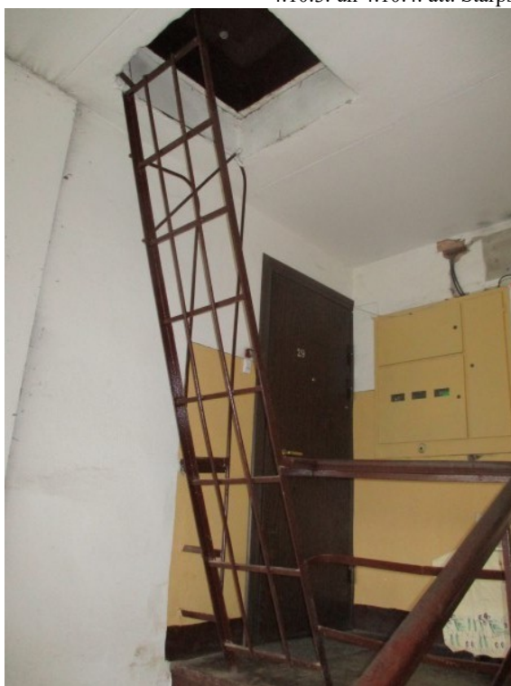
4.10.5. att. Metāla konstr. kāpnes nokļūšanai bēniņos
