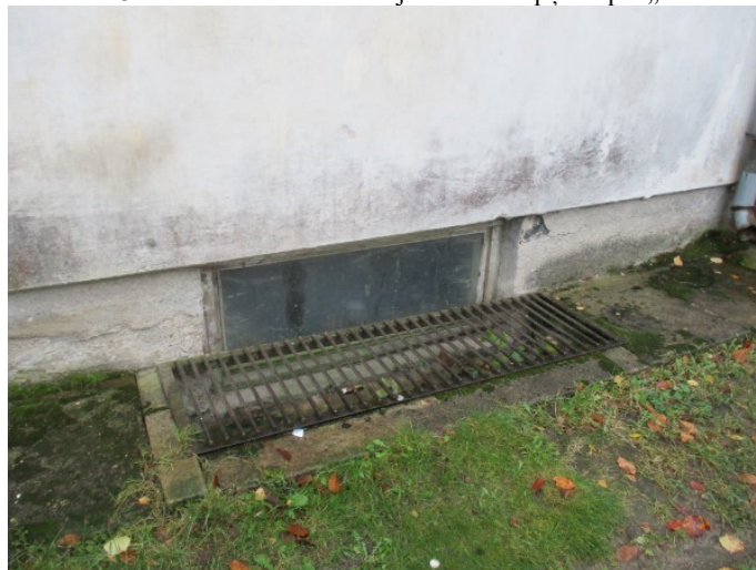
4.13.6. att. Koka konstrukcijas logi pagrabstāvā
