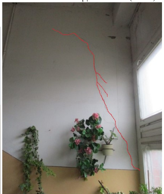
4.2.4. att. Plaisas mūra sienā (kāpņu telpā "E")
