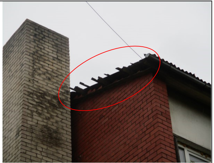
4.8.10. att. Bojāts jumta segums un latojums
