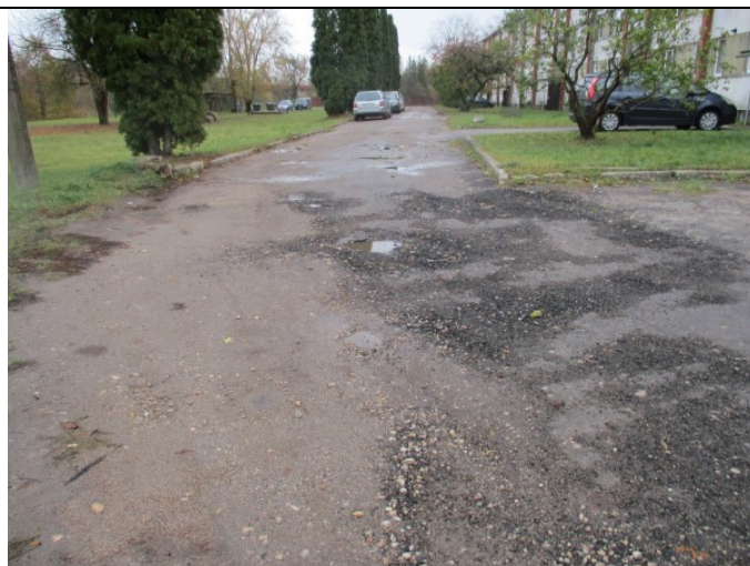
3.1.4. att. Asfaltbetona segums ar virsmas bojājumiem
