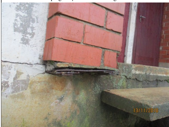
4.2.3. att. Pilastru balstu metāla elementu korozija
