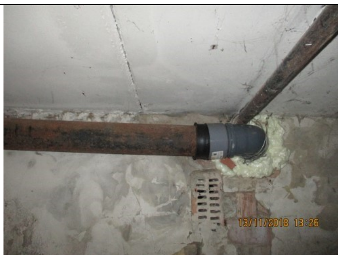
5.1.2. att. Korodējušas čuguna caurules
