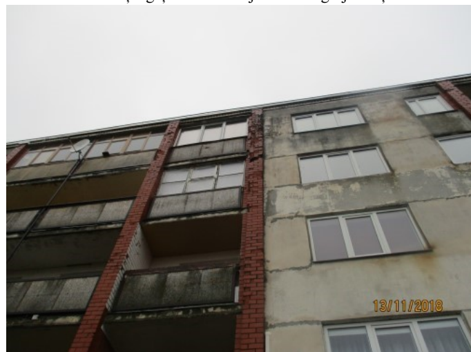
4.2.4. att. Ķieģeļu mūra erozija sienu augšējās daļās
