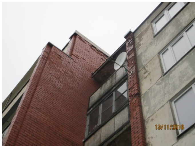
4.2.2. att. Ķieģeļu mūra erozija sienu augšējās daļās
